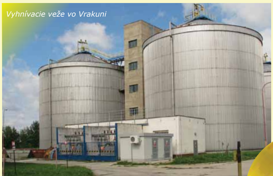
Prevádzka ústrednej čistiarne odpadových vôd
