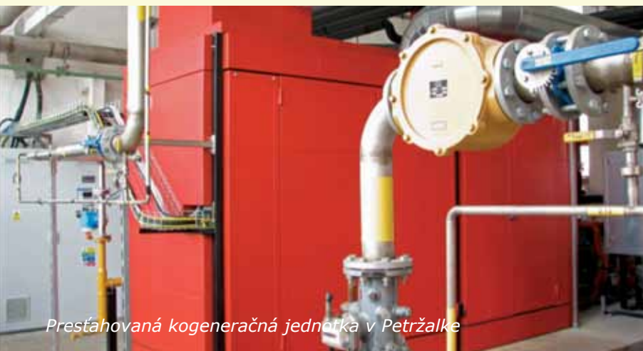
Kogeneračná jednotka APG 1000 pred zakrytovaním
