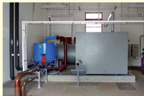
Zariadenie na dávkovanie externých substrátov v Petržalke
